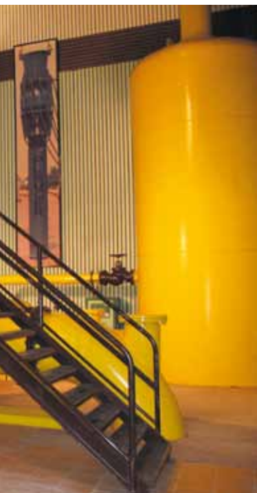
Depuis la salle des commandes, descente à 40 mètres de profondeur dans la station de captage des eaux de la source du Lez pour atteindre la salle souterraine où sont installées les pompes.
