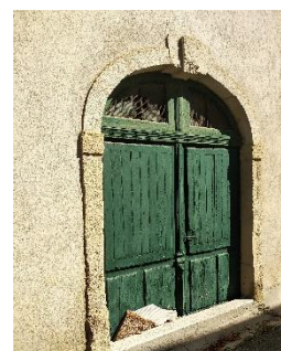
Porte charretière Exemple d'enduit non conforme
