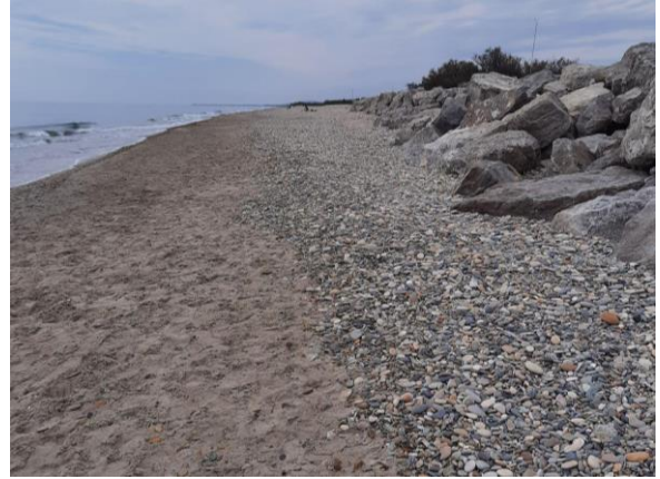
Illustration 68 : Autre exemple d'un vieil enrochement sur le lido de Villeneuve-lès-Maguelone, en voie de ruine, et du blocage sédimentaire à ses pieds (SaVE, 2023).
