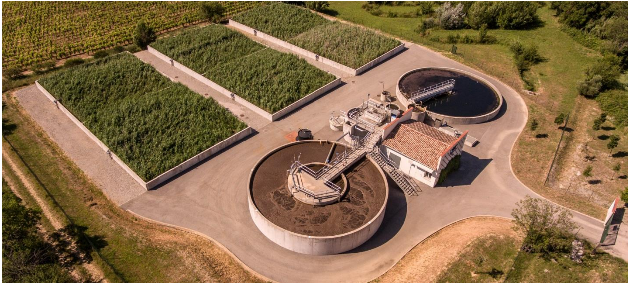
Figure 19 : Station d’épuration de Beaulieu Restinclières
